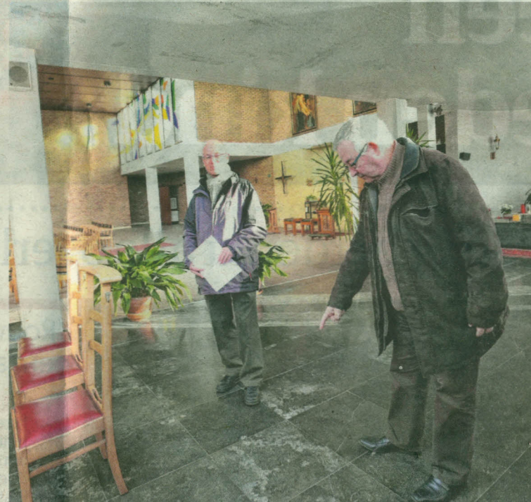
Leo Cruysweegs en Daniël Corten tonen de schade in de moderne parochiekerk. FOTO W&F
